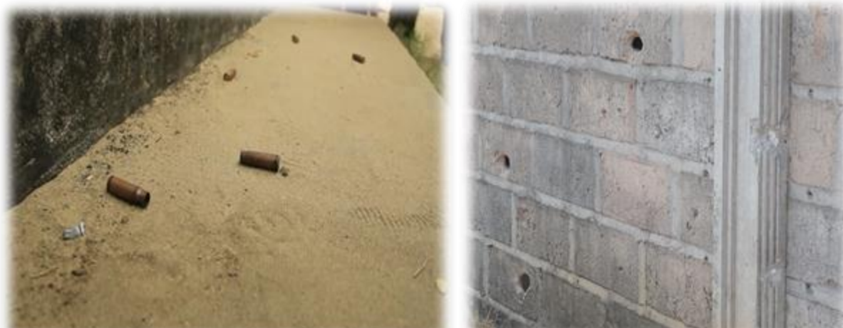
Douilles retrouvées sur le lieu de la fusillade le 21 juillet 2016 Impacts des balles sur mur de la parcelle du voisin de feu
